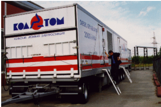
Mobilt nødkraftverk (Foto: Statens strålevern).
