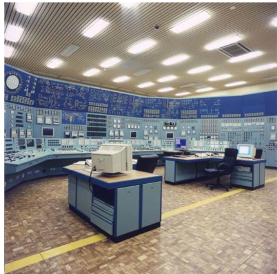
Kontrollromsmiljø ved Kola kjernekraftverk (Foto: Kola kjernekraftverk).
