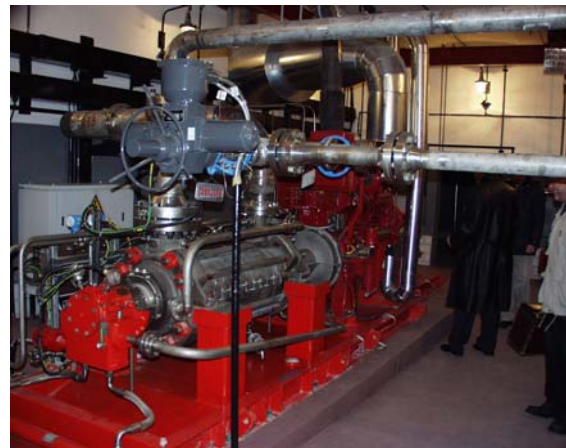
Dieseldrevet pumpe levert som del av samarbeidsprosjekt mellom Kola kjernekraftverk og nordiske land for å bedre kjølingen av dampgeneratorer i krisesituasjoner (Foto: Statens strålevern).
