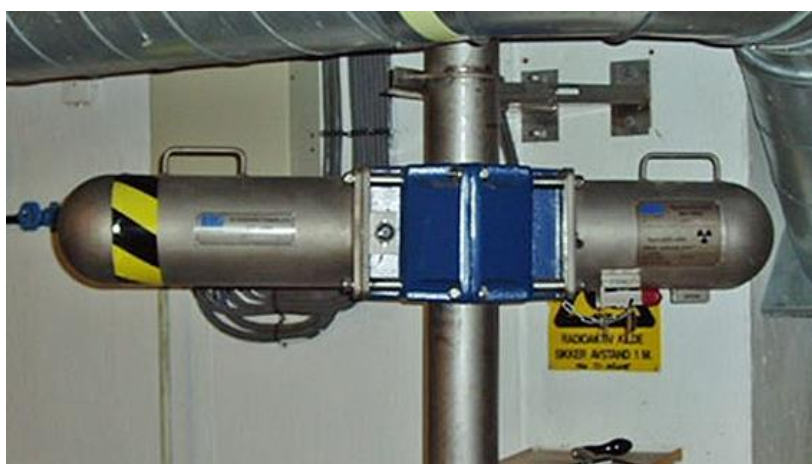
Figur 5.4 En tetthetsmåler som er satt fast med klemmer om røret der målingene skal utføres. Den radioaktive kilden befinner seg i beholderen til høyre, og detektoren til venstre. Måleinstrumentet brukes til kontinuerlige målinger av andel tørrstoff i forhold til væske i massen som strømmer i røret. Foto: Statens strålevern.
