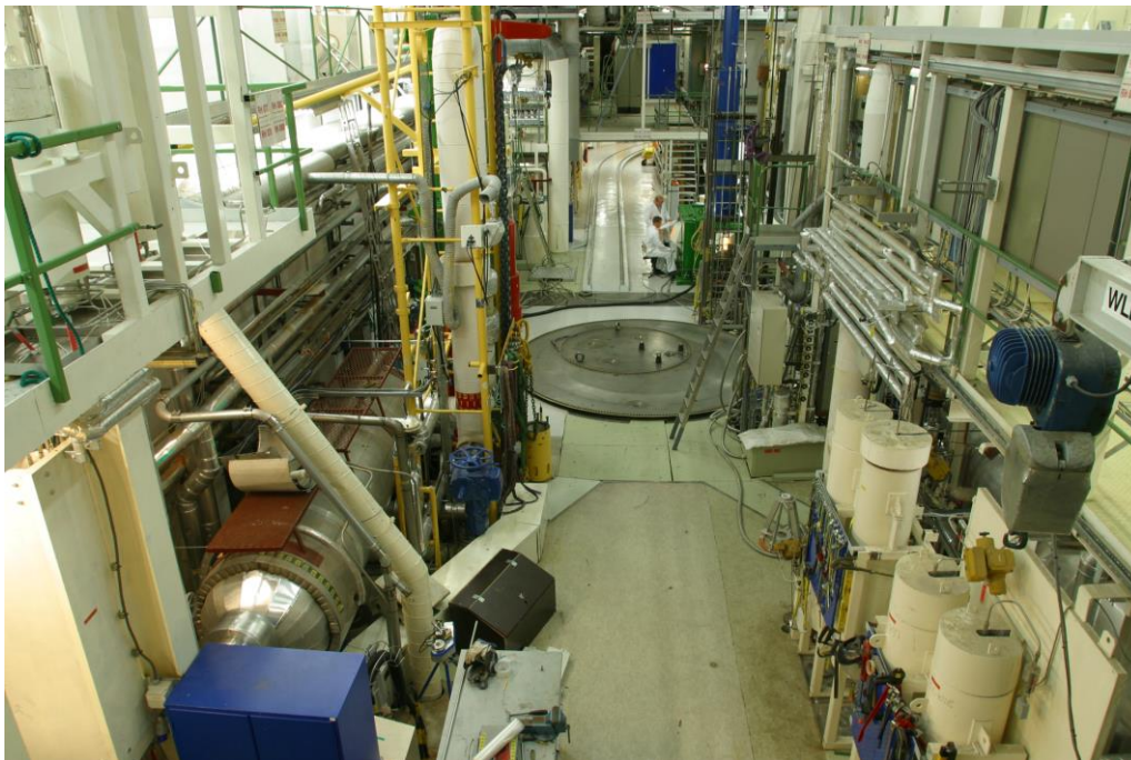
Figur 7.2. Reaktorhallen til HBWR. I midten vises reaktorlokket. Foto: IFE.
