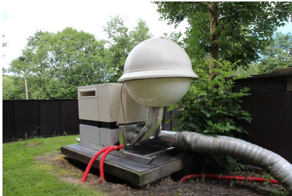
Vi har seks luftfilterstasjonar for å overvake luftmassane i Noreg. Dette er luftfilterstasjonen på Østerås. Foto: DSA.
