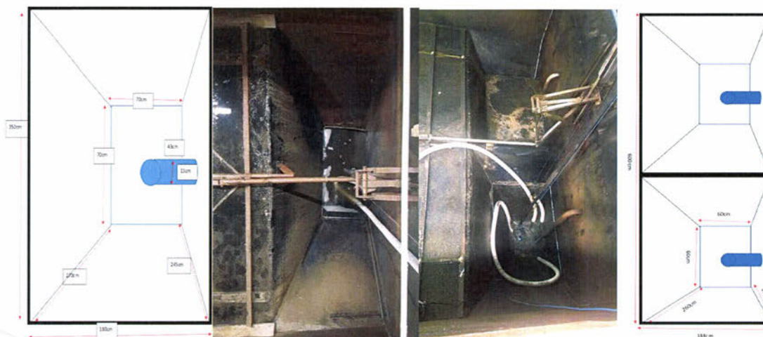
Bilde 7: Oversiktsbilde av slamlommen.
