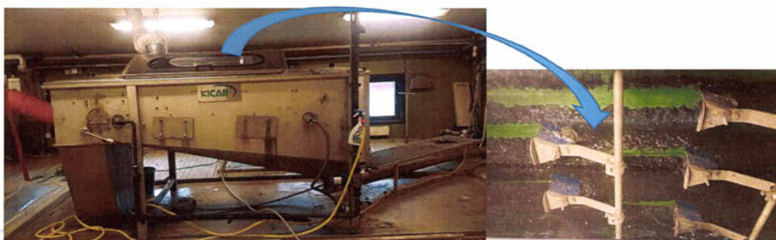
Bilde 11: Oversiktsbilde av slamfortykker (KICAB K-900).
