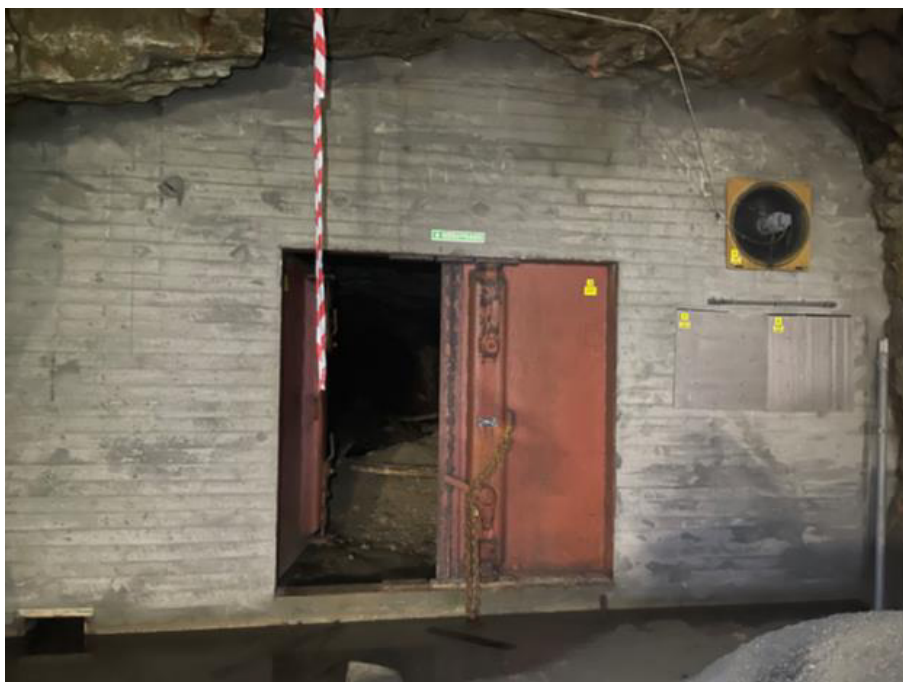
Figur 1 Indre port, merk sirkulær åpning oppe til høyre samt luke nede til venstre. Portene lar seg ikke lukke fullstendig.
